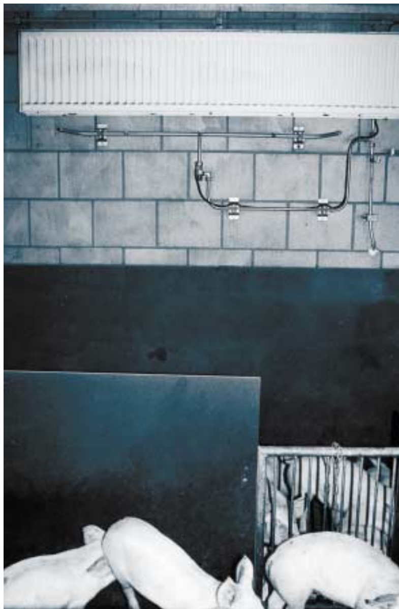
Op de muur is een hogedrukleiding met enkele nozzles aangebracht, waardoor de olie-emulsie wordt verspreid door de afdeling
