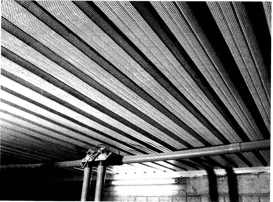
Het plafondventilatiesysteem geleverd door Aerts Electro
