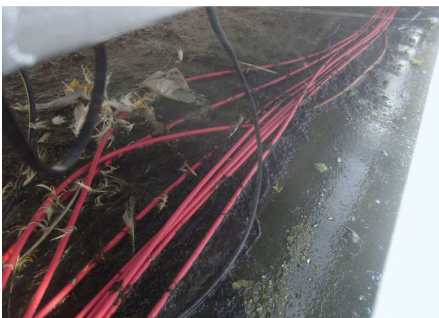
Nog een praktijksituatie. Hier liggen de kabels gewoon los op het dak.
