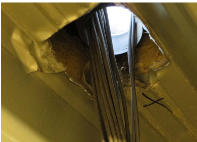
Een praktijksituatie. De kabels lopen direct langs de scherpe rand van het plaatmateriaal.
