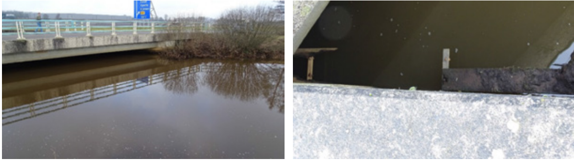
Figuur 3.10 Kapotte loopplank onder de A32 bij Meppel ter hoogte van de Oude Vaart.
