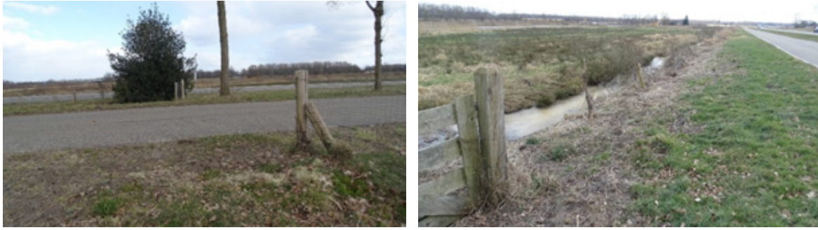
Figuur 3.7 Steenwijkerweg t.h.v. natuurontwikkelingsgebied de Lindevallei. Het raster zou hier moeten worden verlengd. Op de rechterfoto het vervallen raster aan de andere kant van de weg.
