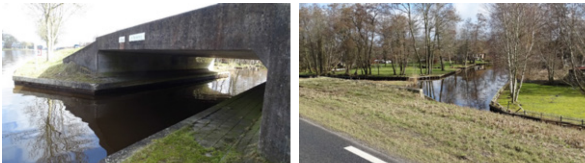
Figuur 3.6 Droge onderdoorgang bij de 2 e Thijssenbrug. Rasters ontbreken.
