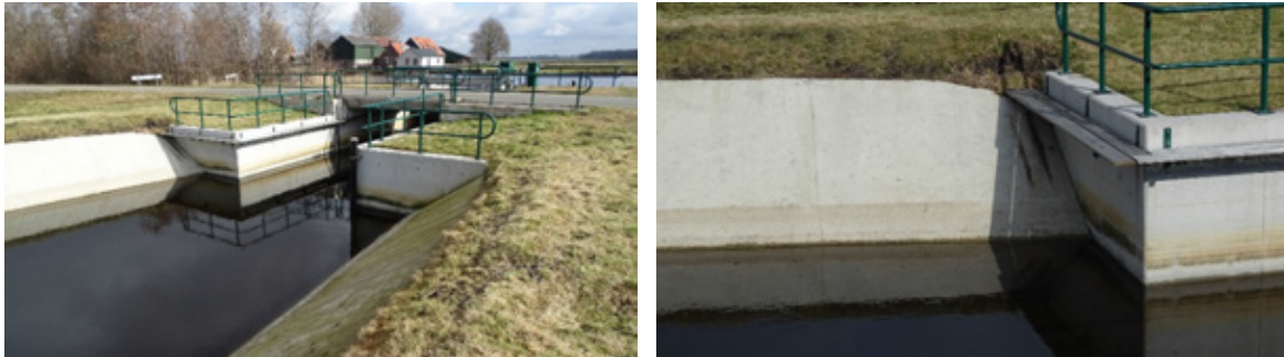
Figuur 3.5 Stuw bij Wetering-West. De loopplank is onbereikbaar voor otters en geleidende rasters ontbreken, waardoor otters alsnog de route over de weg nemen.
