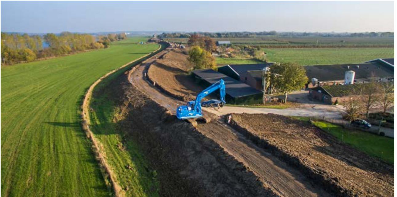
Figuur 8-9 Bakprofiel voorafgaand aan de aanleg van een kruinweg bij dijkversterking in Ingen (bron: Pascal Ogink, Combinatie dijkverbetering HOP (GMB - Van Oord)).
