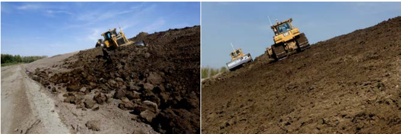
Figuur 8-6 Aanbrengen deklaag (links) en profilering dijk (rechts) (bron: Daan Jumelet, DEME).
