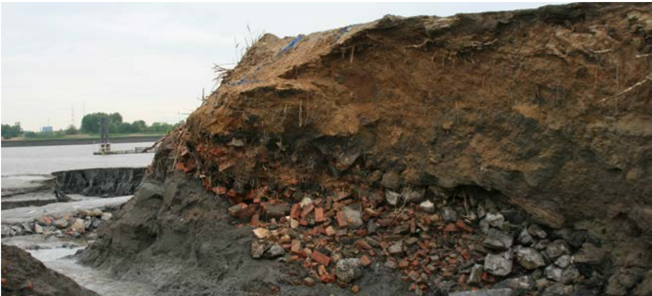
Figuur 2-11 Puin in dijklichaam (bron: Waterbouwkundig Laboratorium, Vlaanderen).
