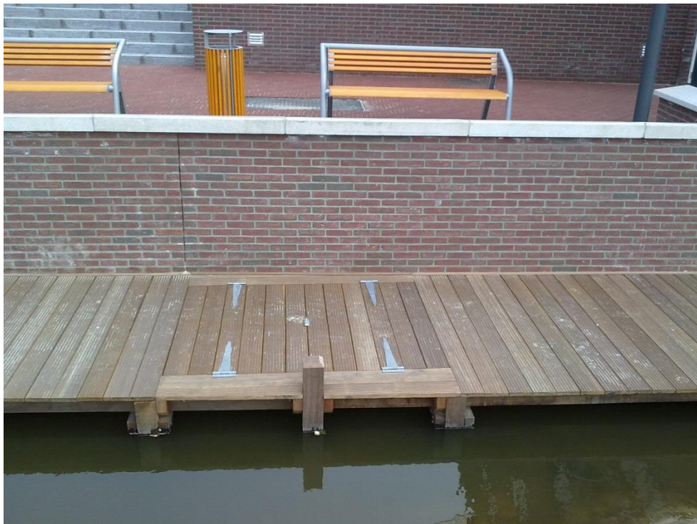
Figuur 7.4 | Inlaat van een TEO systeem. De inlaat is onder water geplaatst onder een steiger.
