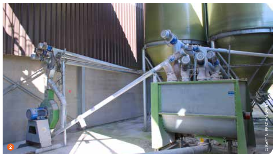
1 Opbouw van de installatie. Let op de veiligheidslijn van de installatiemedewerker. 2 Op 'De Wolfputte' wordt het voeder voor de legkippen zelf bereid met deze installaties.
