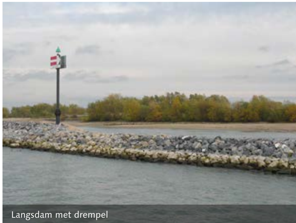
Benedenstroomse deel van de langsdam met invaart
