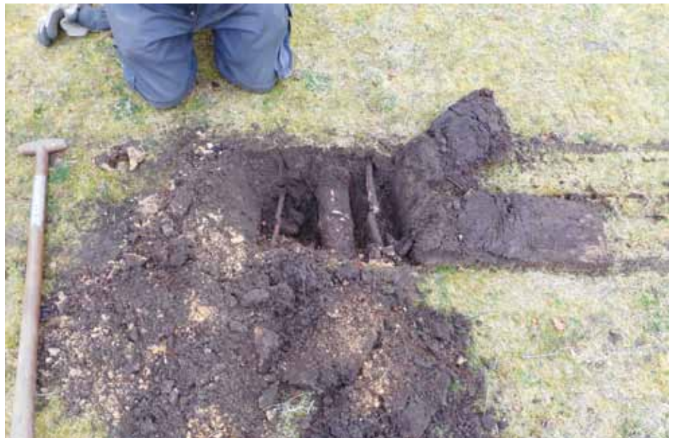
Tien centimeter dikke boomwortels? Geen probleem, de wortelsnijder sneed de wortel zonder schade door. Het gat werd met een schop gemaakt om de omvang van de wortel te meten.
