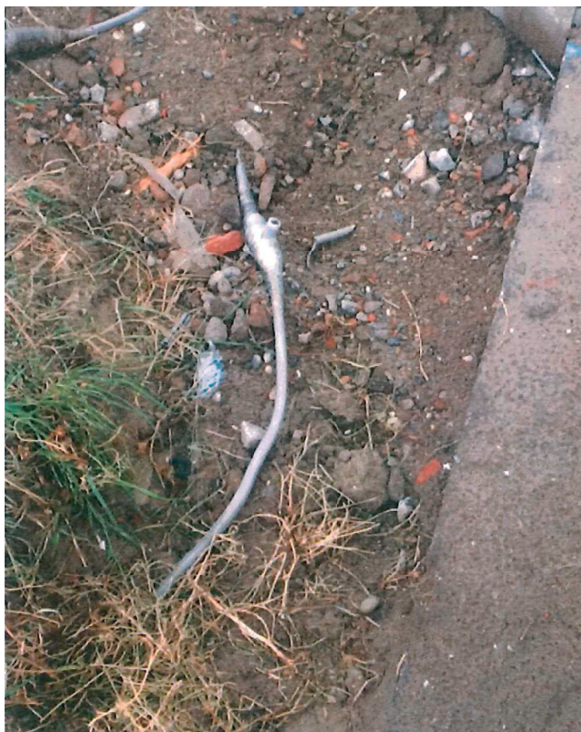
De netbeheerder van deze kabel nam de schade voor eigen rekening.
