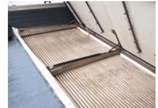
Onder een klep zie je de lamellen waar de lucht langs wordt geleid.
