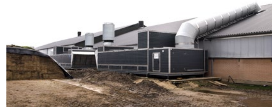
Een 8 meter lange unit waarin de lucht wordt verwarmd dan wel gekoeld.
