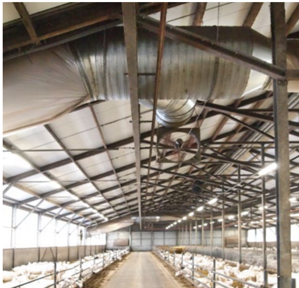
Via een buis langs het dak komt de lucht boven de voergang terecht en wordt daar met behulp van een ventilator verder de stal ingebracht.
