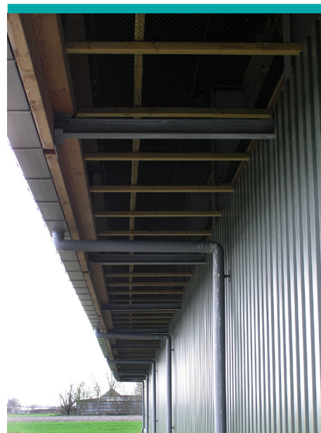
Foto 1 Overstekruimte waarmee buitenlucht wordt binnengelaten die gemengd wordt met de opgewarmde lucht van het zonnedak om de juiste temperatuur te verkrijgen. Dit wordt met kleppen geregeld.
