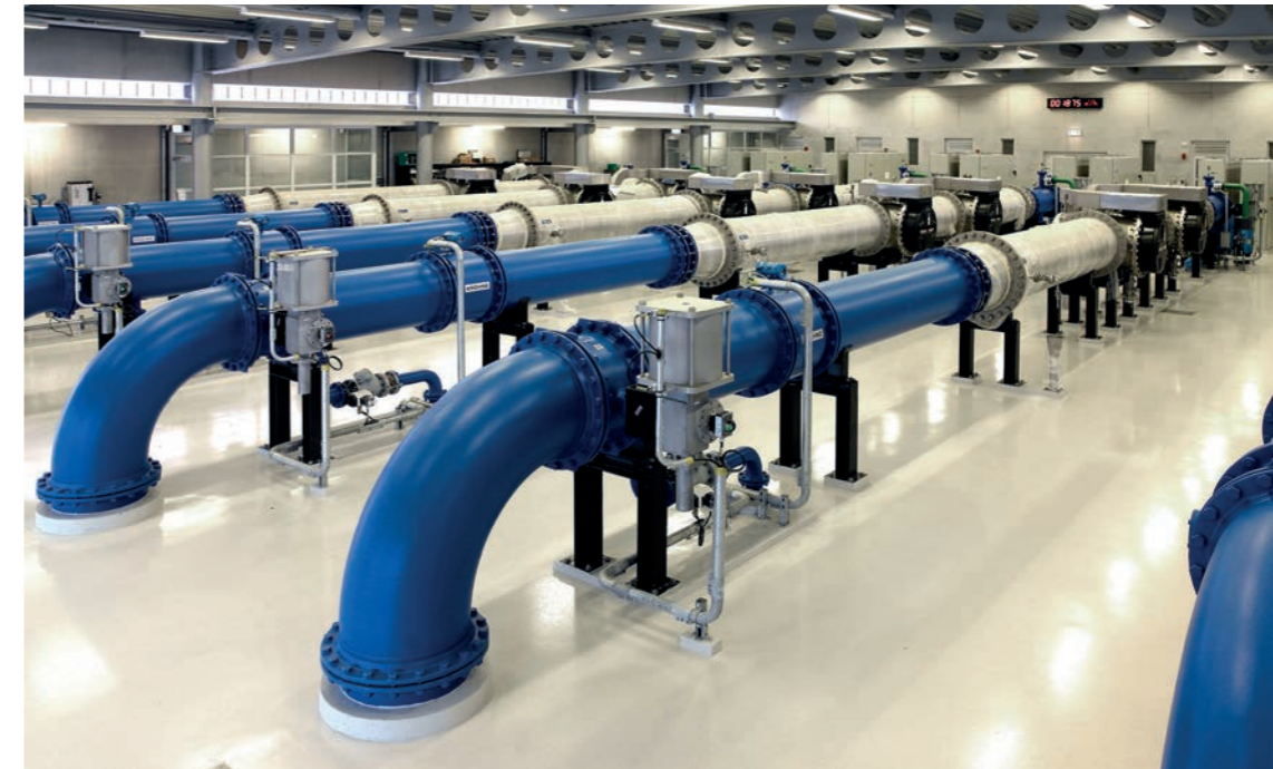
Figuur 3 – Een van de UV-zuiveringsinstallaties van Evides
