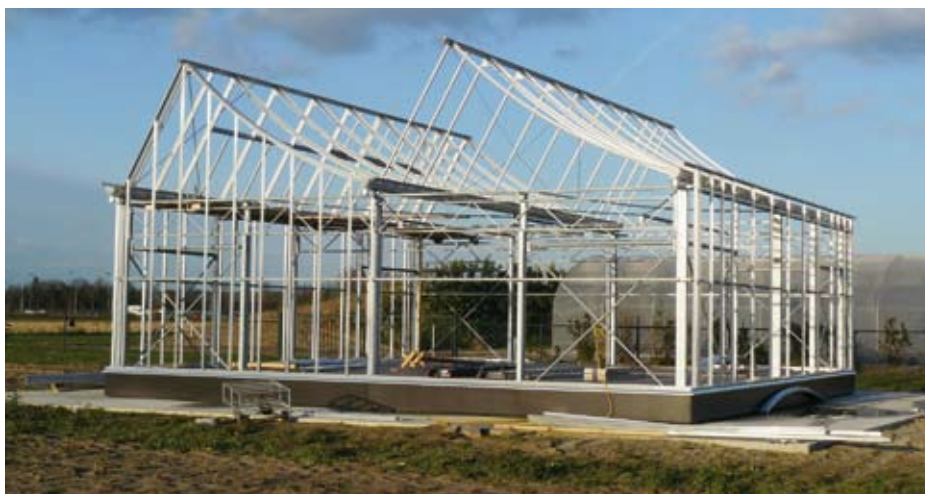
Het prototype van de elektriciteitleverende kas (ELKAS) is in Wageningen in aanbouw.
