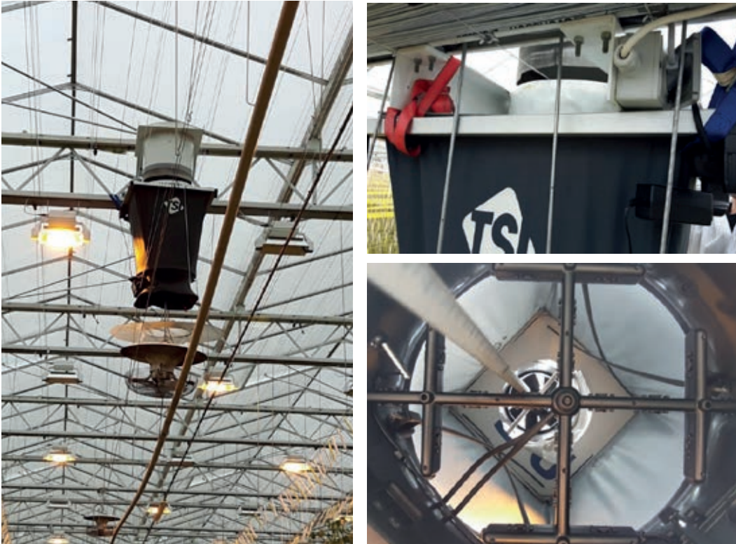
Figuur 2 Luchtstroommeter geïnstalleerd bij de Ventilation Jet.
