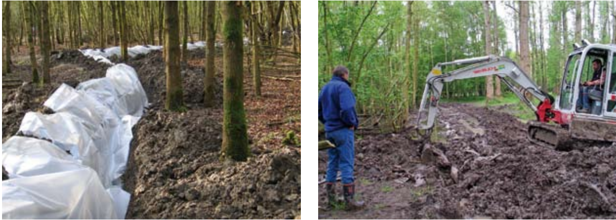
Figuur 9 Aanleg van foliekaden in het eikenvak (links) en verwijdering van folie na beëindiging van de proef (rechts).
