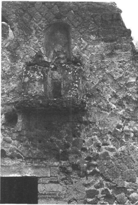
Afb. 13 - Toilet op de bovenverdieping. De vloer van de galerij waarop dit toilet zich bevond is nu ingestort.
