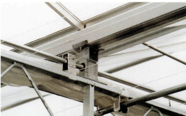
Geleidingsdraden van scherm zowel onder als boven. Boven: trekduwbuis belichting; onder: trekduwbuis scherming (foto PBG/van Vliet Growing Solutions)
