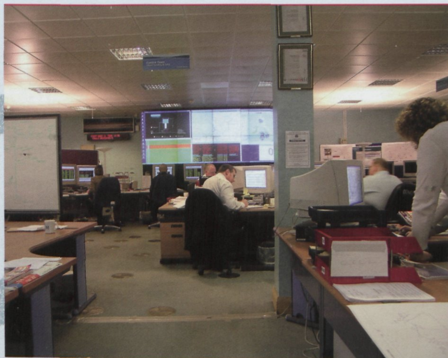
De centrale controle ruimte.
