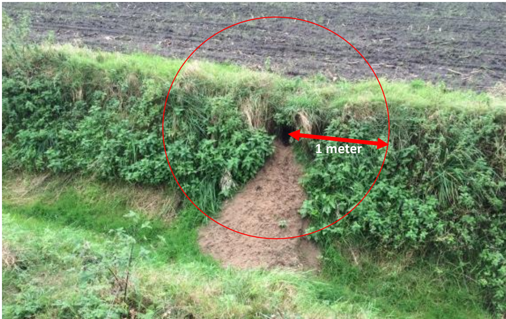
Figuur 8. Voorbeeld voorbeeld dassenpijp in een talud bij het werkpad (foto: B. Brugmans).
