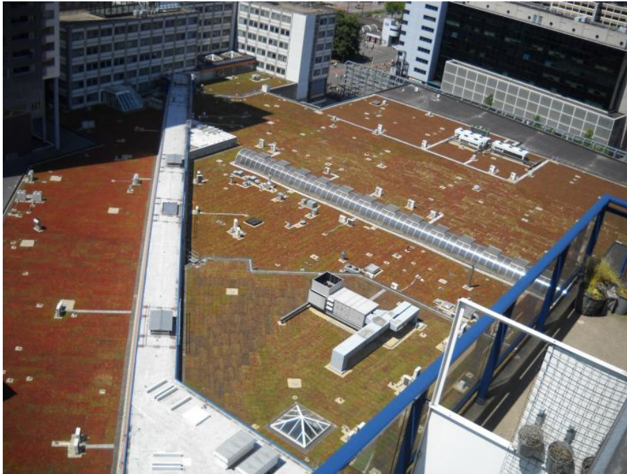
Figuur 3.5 Groendak van ca. 21.000 m 2 op het winkelcentrum Alexandrium, Rotterdam (bron: www.multifunctioneledaken.nl ).
