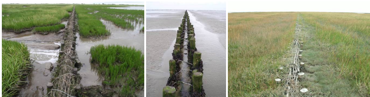
Foto 1 links: Onderspoeling/achterloopsheid bij dam; midden: Leeggespoelde, niet meer onderhouden dam in achterste/derde bezinkveld en rechts: Een vrijwel onder het maaiveld verdwenen rijshoutdam.
