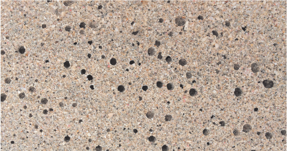
Afbeelding 6: Bij indringen van water in de poriën van onverzadigd zand zal er lucht moeten wijken, wat hier uit de gaatjes borrelde
