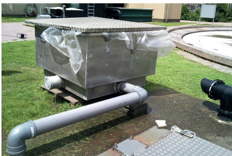
OPSTELLING KELDERBALLON RWZI ZAANDAM
