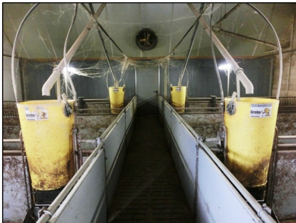
Overzichtsfoto van een afdeling met acht hokken, met de luchtinlaat via betonroostervloer van de voergang en de luchtuitlaat via de koker met meetventilator en smookkleppen boven de deur, naar het centrale luchtkanaal
