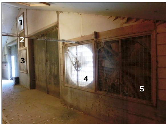
Binnenaanzicht van de eindgevel met vijf in de afbeelding genummerde v-snaarventilatoren
