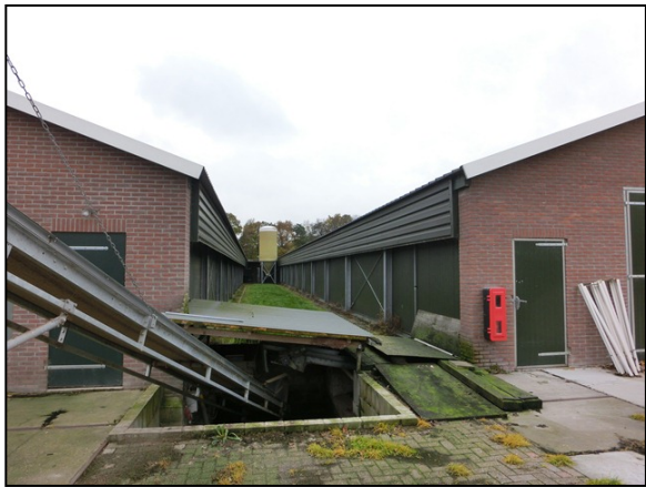
Zijgevel met inlaatventielen onder winddrukcap
