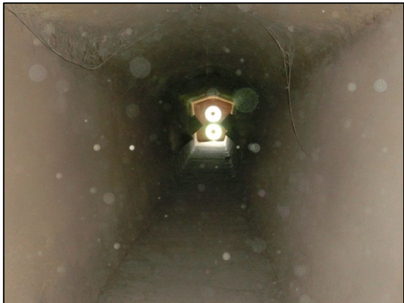
Het centrale luchtkanaal in de nok van het gebouw
