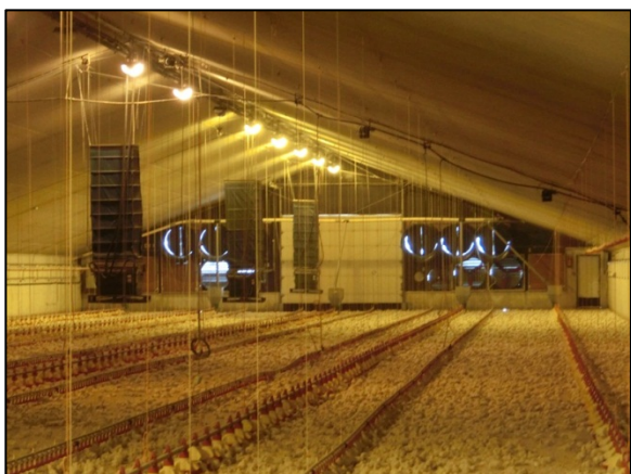
Binnenaanzicht van de achtergevel met (v.l.n.r.): 7 ventilatoren, een roldeur, 7 ventilatoren en een toegangsdeur
