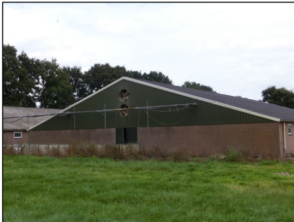
Achtergevel met twee ventilatoren aan het einde van het centrale luchtkanaal
