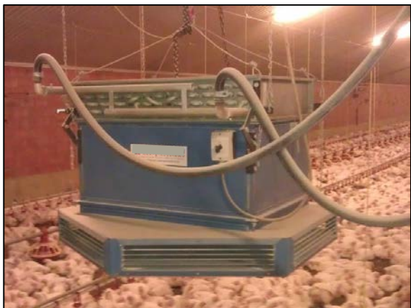
Eén van de twee indirect gestookte warmteheaters
