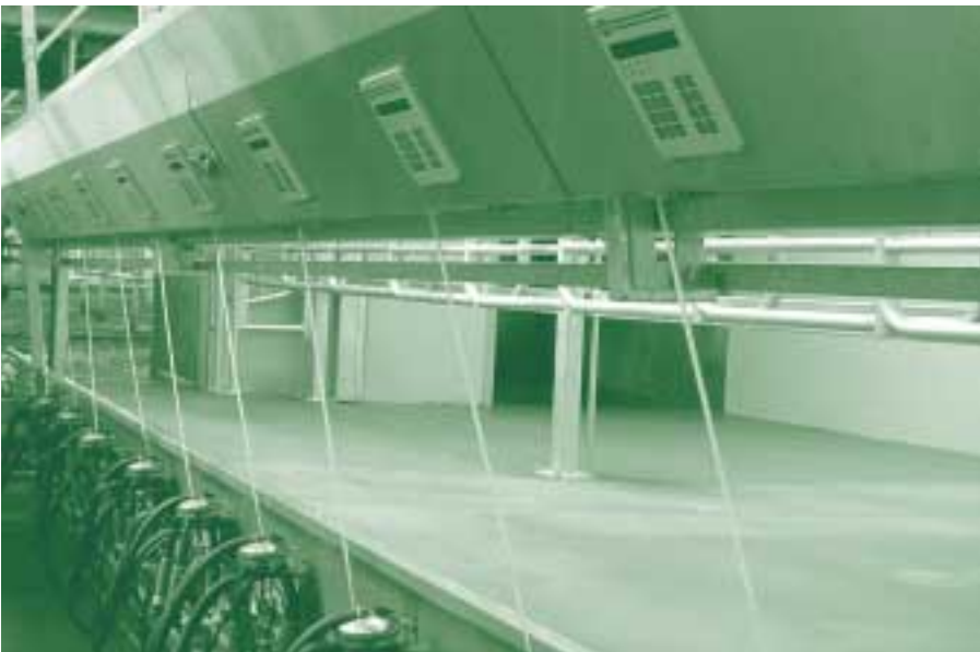
De bekabeling en de diverse slangen worden weggewerkt in roestvaststalen kabinetkasten.
