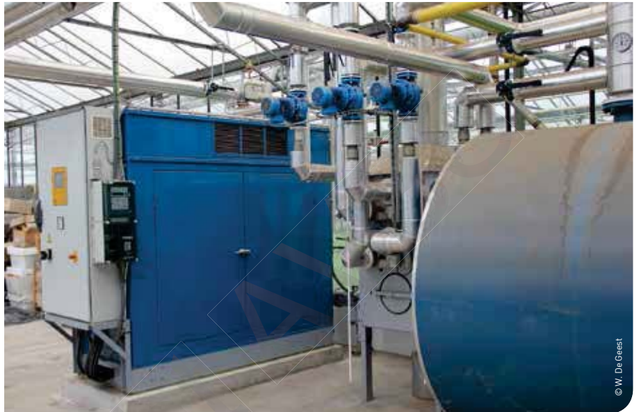
▲ Een batterij installeren is alleen zinvol als er op je bedrijf ook hernieuwbare energie geproduceerd wordt. Ook de integratie met een WKK kan zinvol zijn.
