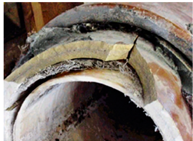
Figuur 6.7 Wortelingroei tussen buiswand en liner
