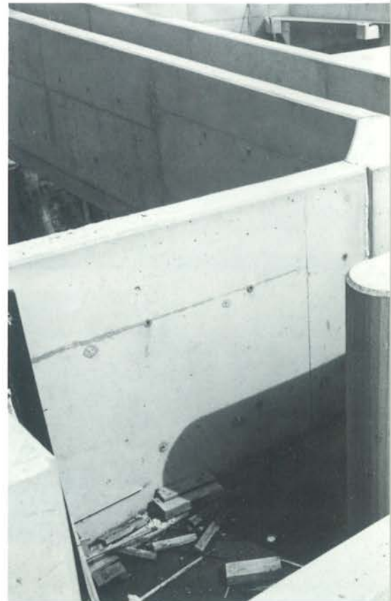
De zandvanger en het centraal verdeelstation, gezien vanaf de gistingstanks
