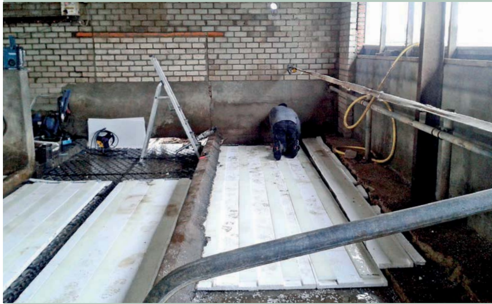
Lamellen in de mestgang en onder de ligplaats koelen de mest en de koe
