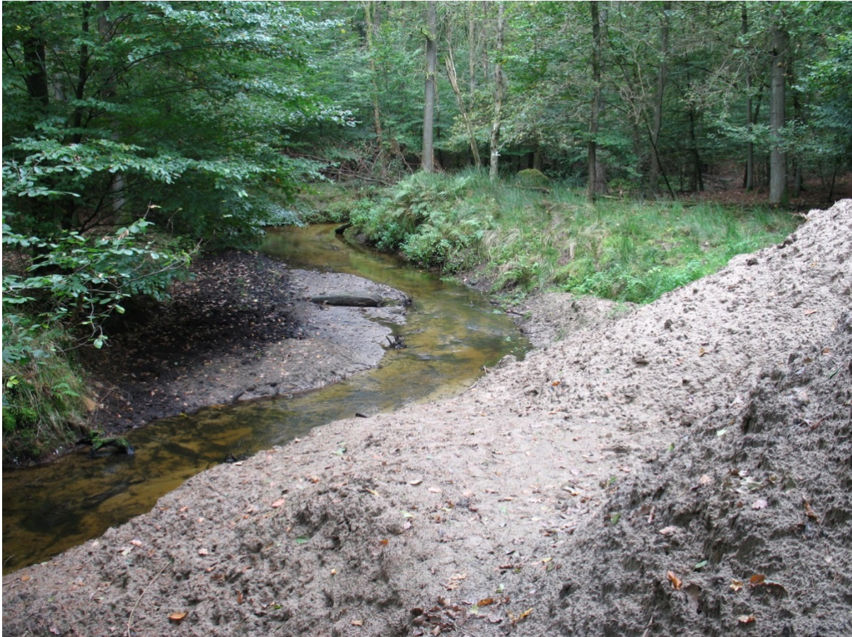
Foto 1.1. Suppletielocatie ter hoogte van De Doorbraak (oostelijke tak). Het zand wordt met behulp van een kraan opgescheept uit de zandberg en vervolgens in de beek gestort, net zolang totdat er te veel stuwing bovenstrooms optreedt.
