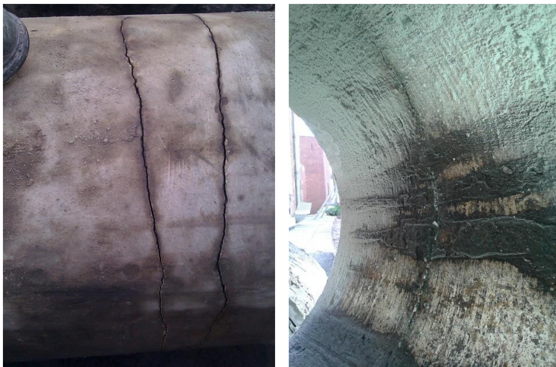
Afbeelding 6. Gebroken persleiding. Links: buitenkant, rechts: binnenkant
