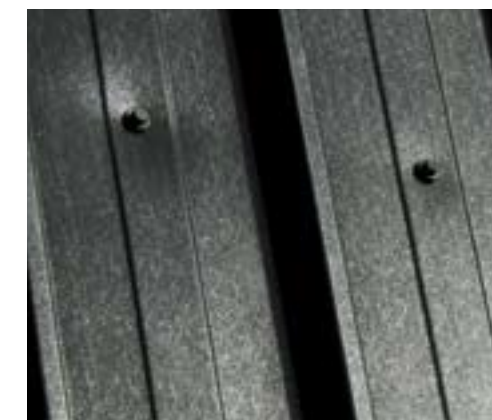
Deuken in de dakbeplating geven kans op lekkage.
