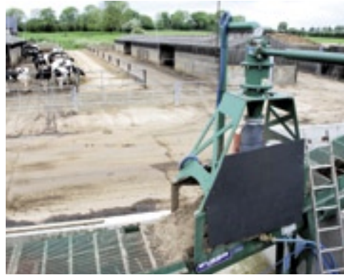
Een cycloonfilter haalt in tweede instantie zand uit de mest en brengt het terug in de zandwasser.
