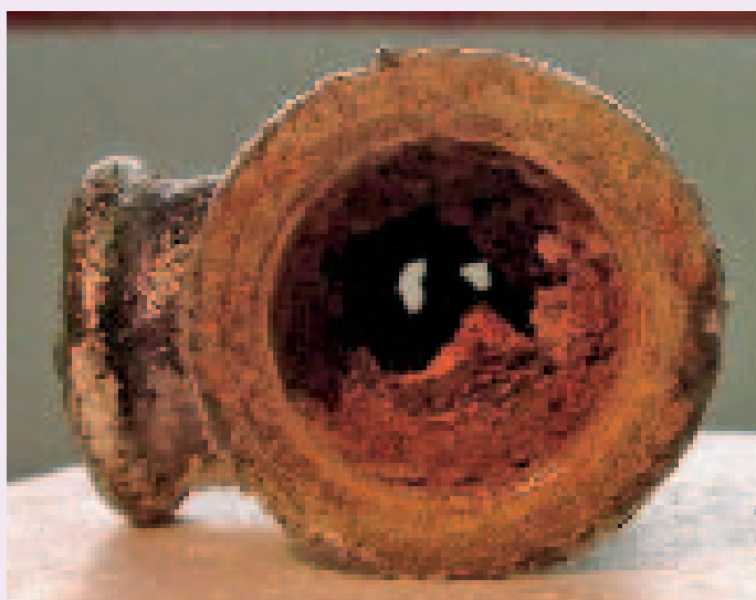
BOCHT IN EEN DRINKWATERLEIDING MET IJZERNEERSLAG
