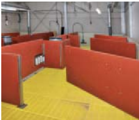
De roostervloer bij Paul en Nieka de Gouw. Eronder liggen buizen die de lucht afzuigen, waardoor ammoniak en vocht snel worden afgevoerd.
