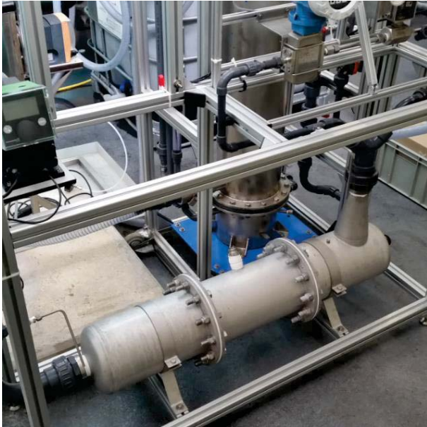
Afbeelding 1: Geoptimaliseerde UV/H 2 O 2 -reactor bij pompstation Heel.
