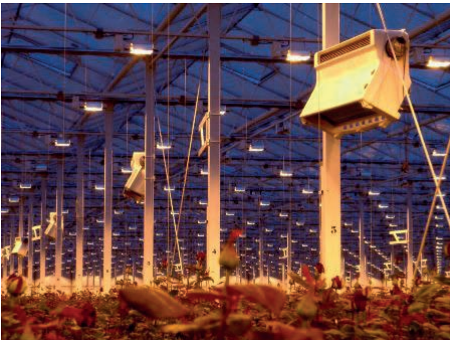
Figuur 4 Voorbeeld van luchtbehandelingskasten boven het gewas, met koelfunctie of LT verwarmingsfunctie [foto: www.lekhabo.nl ].
