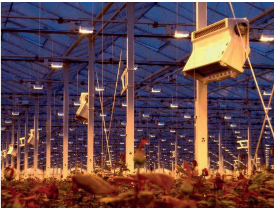
Figuur 4 Voorbeeld van luchtbehandelingskasten boven het gewas, met koelfunctie of LT verwarmingsfunctie [foto: www.lekhabo.nl ].
