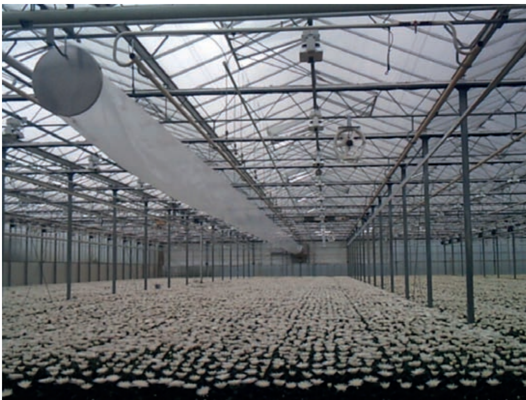
Figuur 1 Proefvak met luchtbehandelingskast en slurf bij Arcadia.
