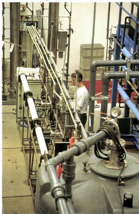
Afb. 1 - De kleine proefinstallatie te Andijk.
