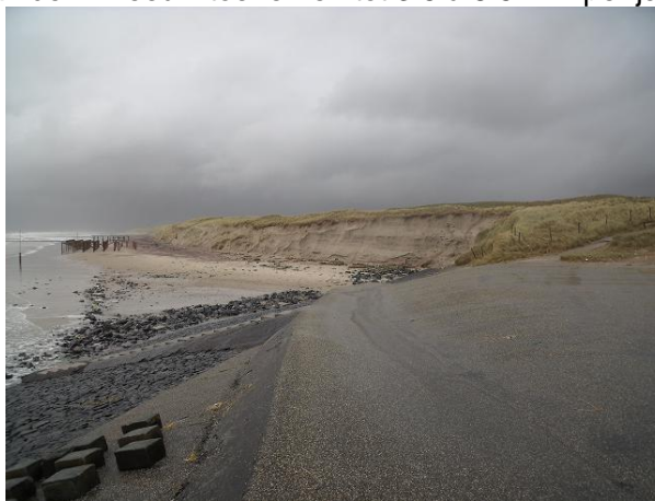
Duinafslag ten noorden van de Pettemerzeewering na een storm in december 2011 (Foto gemaakt door Carola van Gelder-Maas)
