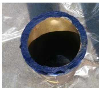
Afbeelding1. Destructief testen met thymolftaleïne op AC-buisdelen. De blauwe kleur betekent dat de buis nog in aanvaardbare staat is.
