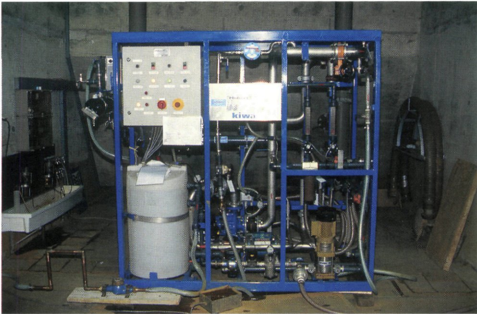
Afb. 5 - Cross-flow microfiltratie-installatie voor zuivering van spoelwater tot drinkwater op zuiveringsstation Aalsterweg (NRE).
