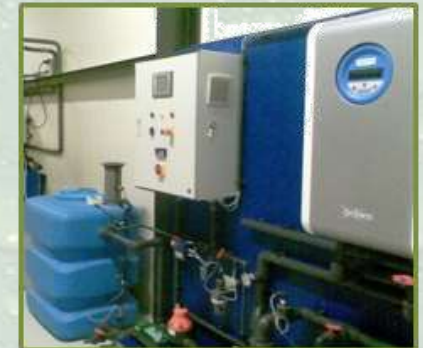
Het elektrolyse systeem
