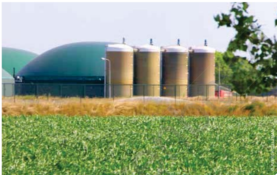
De productiecijfers stijgen, wat betekent dat de bestaande vergistingsinstallaties efficiënter draaien.
