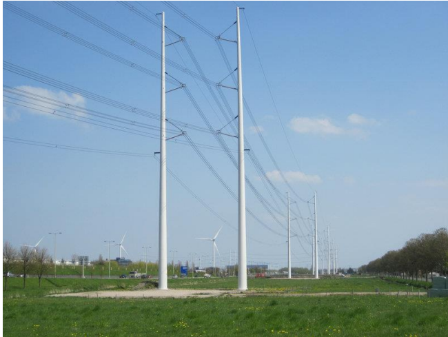
Figuur 1 Wintrack masten
