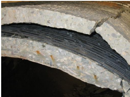
Figuur 7 Spiraalwapening zichtbaar na beproeving van voorgespannen betonnen buis. De deklaag is gebroken als gevolg van de beproeving.
