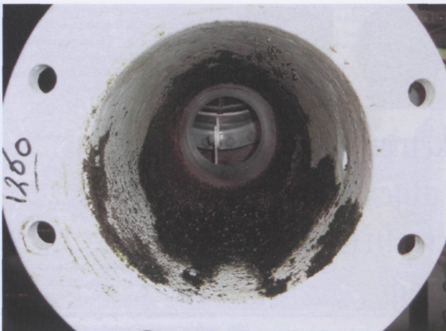
Voorbeeld van algengroei in een leiding bij een UV-installatie van Brabant Water (Bergen op Zoom).
