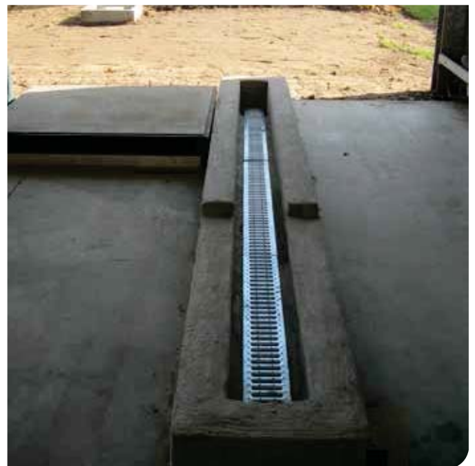
▲ Afvoergoot om restwater belast met gewasbeschermingsmiddelen op te vangen in een opslagtank
