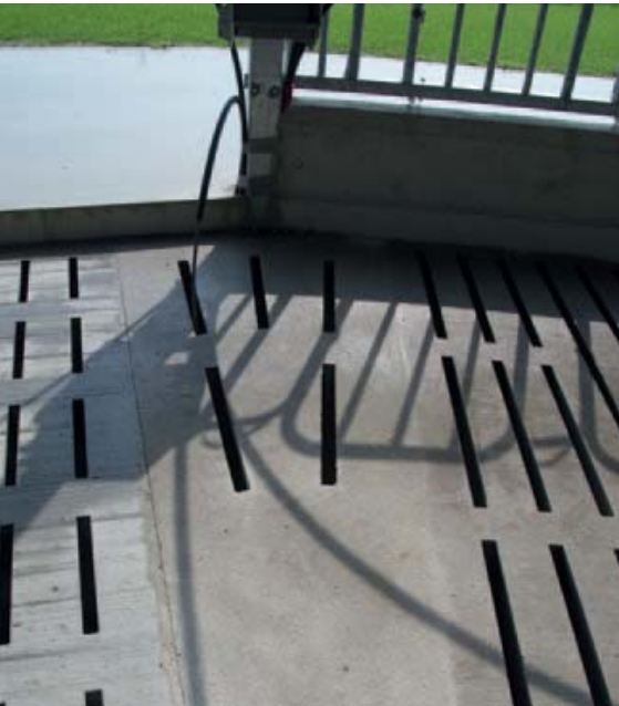
Door de vorm van de stal passen traditionele roosters niet. Op elke hoek zijn daarom stukjes roosters gestort. De gleuven zijn handmatig aangebracht.
