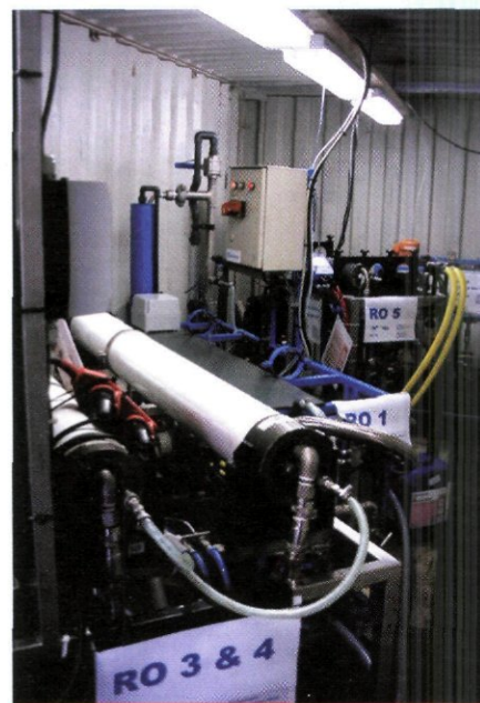
De kleinschalige RO-installaties.
